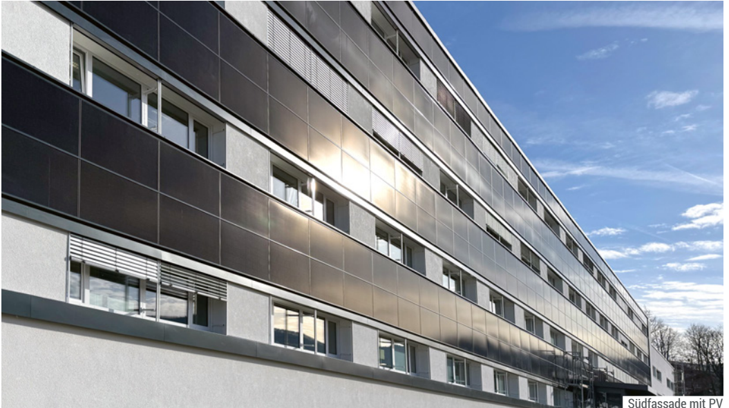
Südfassade mit PV
